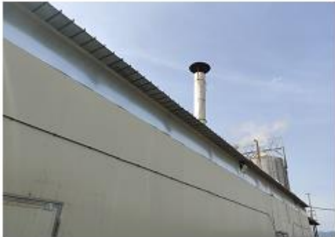
Emissioni in atmosfera: generatore di vapore - combustibile Metano NOx - CO E10
