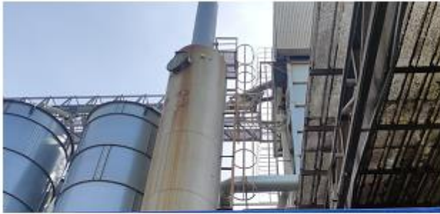
Emissioni in atmosfera: SCRUBBER A TORRE Polveri e emissioni odorigene E3
